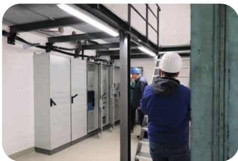
Technik der neuen Wohnanlage „Die tanzende Siedlung“, die mehr als begeistert
