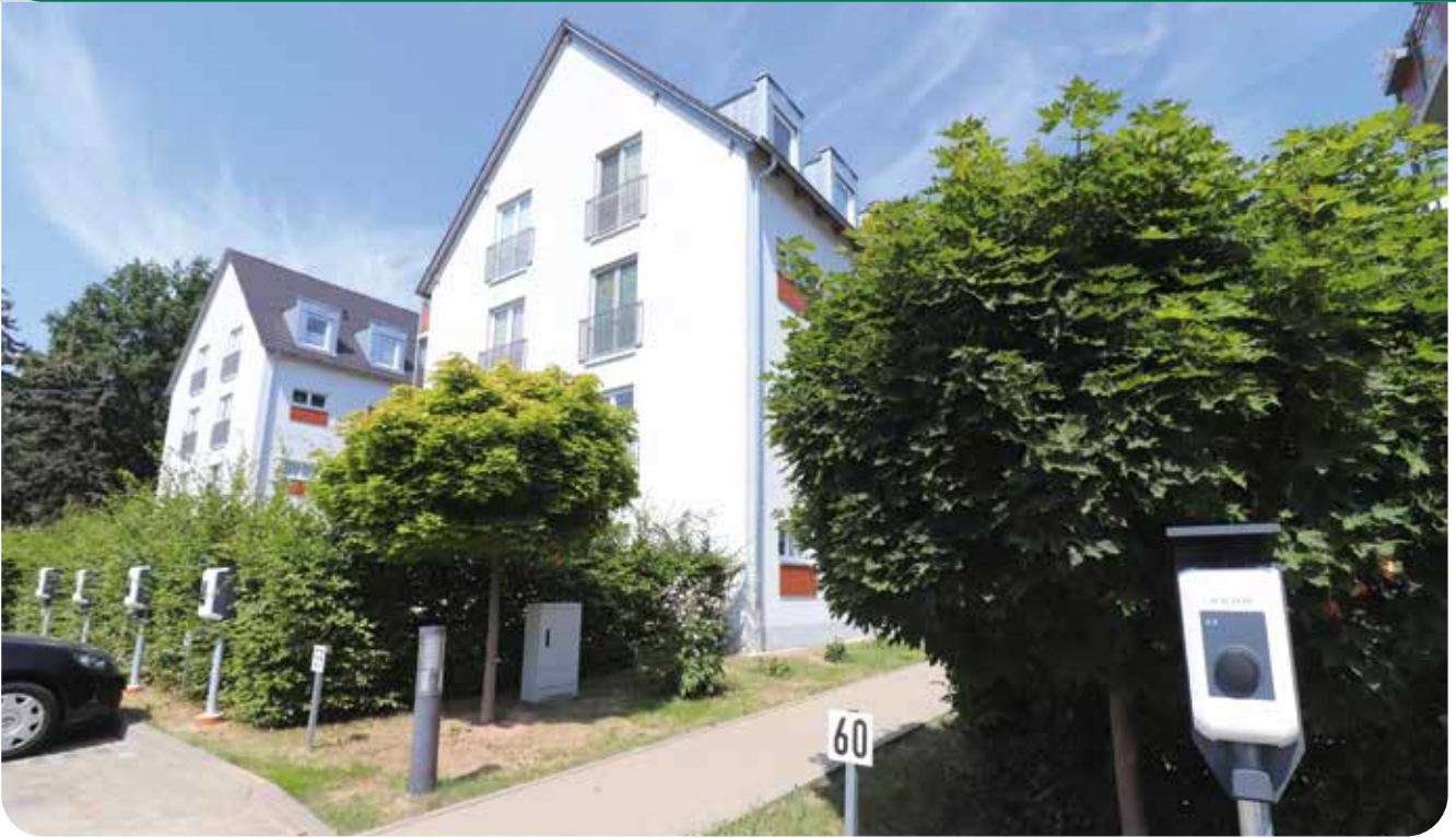
Neue Ladeplätze an den Wohnhäusern am Gutsweg
