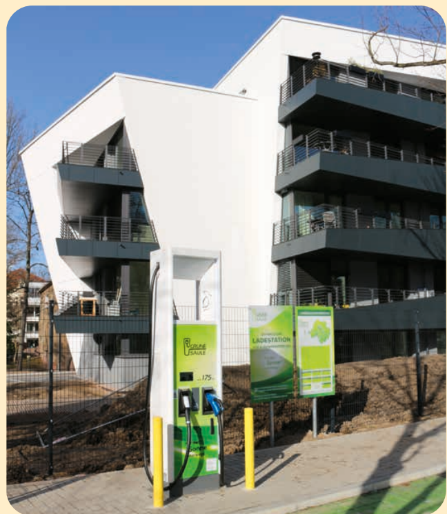
Schnellladesäule am Standort „Die tanzende Siedlung“
