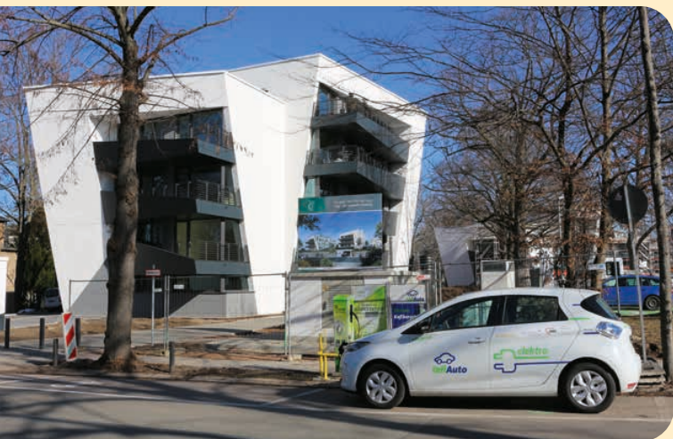
Normalladesäule am Standort „Die tanzende Siedlung“ mit E-Carsharing-Station
